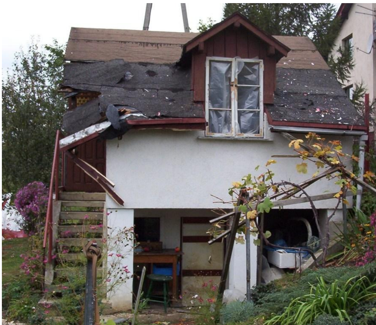
20 – Piętrowy budynek na działce z uszkodzonym przez prawe skrzydło samolotu narożnikiem dachu nad schodami.
