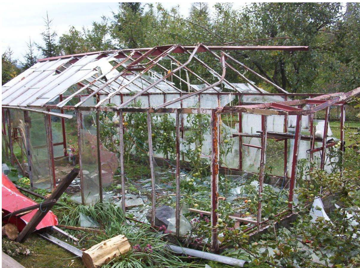
21 – Uszkodzony przez lewe skrzydło samolotu budynek szklarni.
