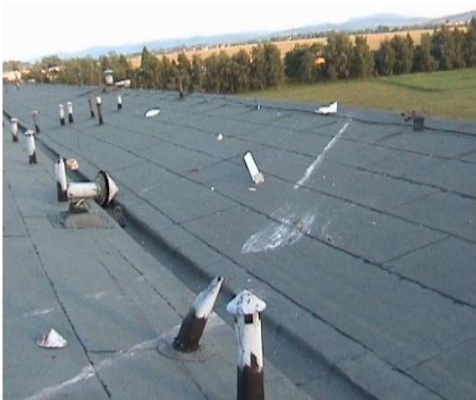
Fot.3 – Ślady samolotu na dachu budynku (w kierunku ruchu samolotu) – widoczne połamane odwietrzniki dachowe i szczątki samolotu, na środkowym planie zastrzał skrzydła.
