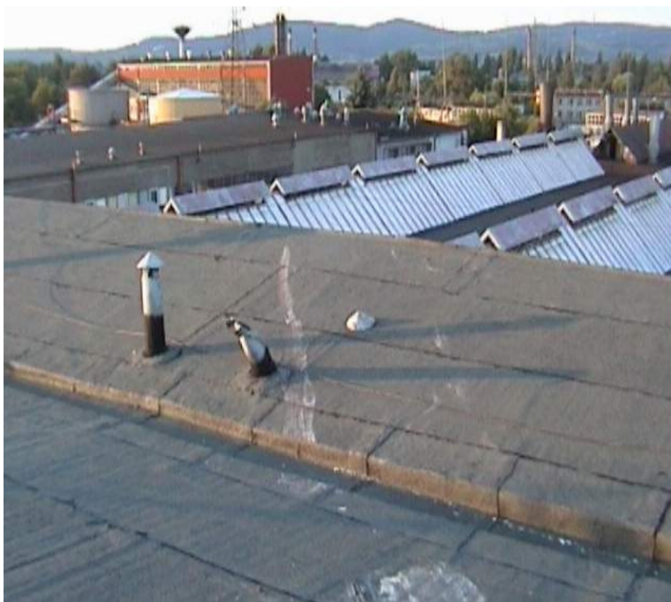
Fot.4 – Ślady samolotu na dachu budynku (w kierunku przeciwnym do ruchu samolotu).
