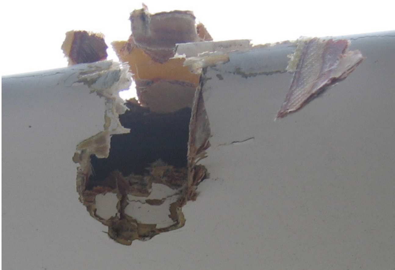
Fot.7 – Uszkodzenia krawędzi natarcia statecznika poziomego, spowodowane uderzeniem ramy osłony.
