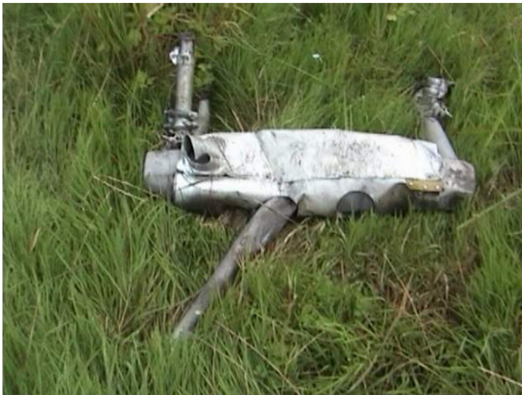
Fot.24 – Oderwany kolektor spalin z nagrzewnicą.
