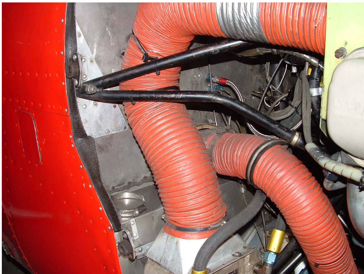
Fot.11 – Zgięty pręt łoża silnika.
