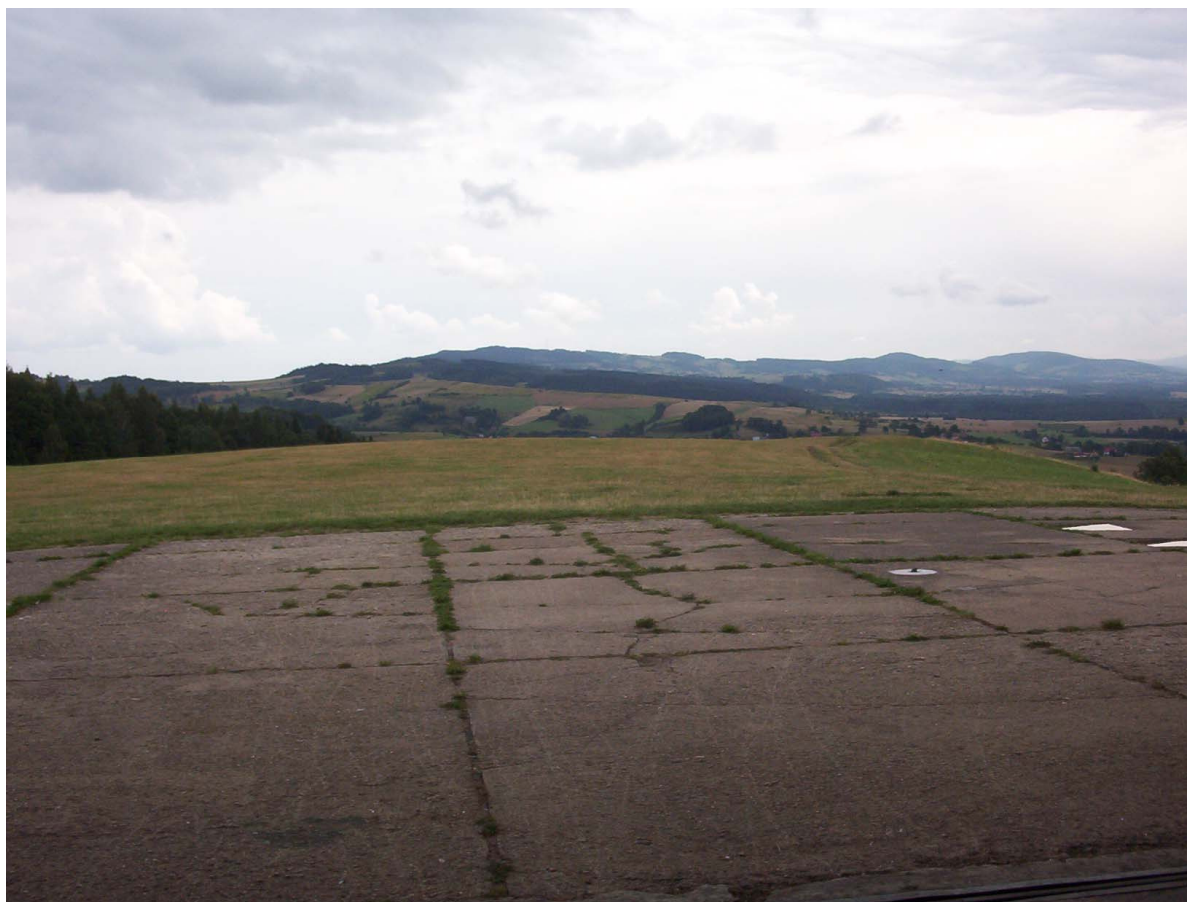
Fot.6 – Płyta betonowa przed hangarem, w który uderzył samolot.
