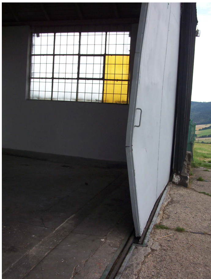
Fot.8 – Uszkodzony segment drzwi hangaru.
