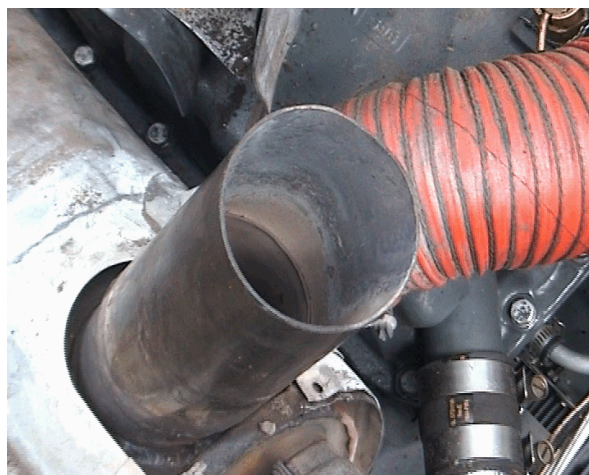
12 – Zbliżenia elementów układu wydechowego. Widać brak sadzy na wewnętrznej powierzchni rury wydechowej.
