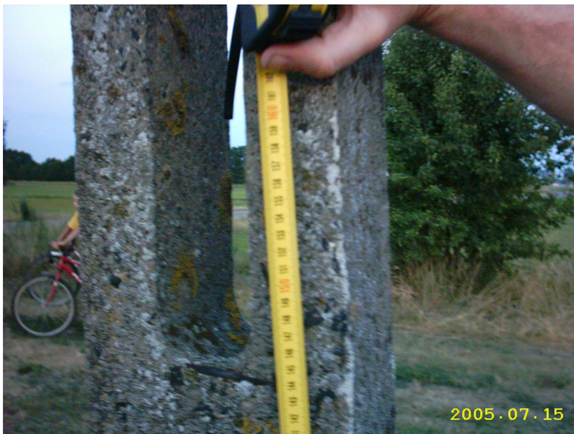
Fot.12 – Ślad uderzenia skrzydłem na betonowym słupie.
