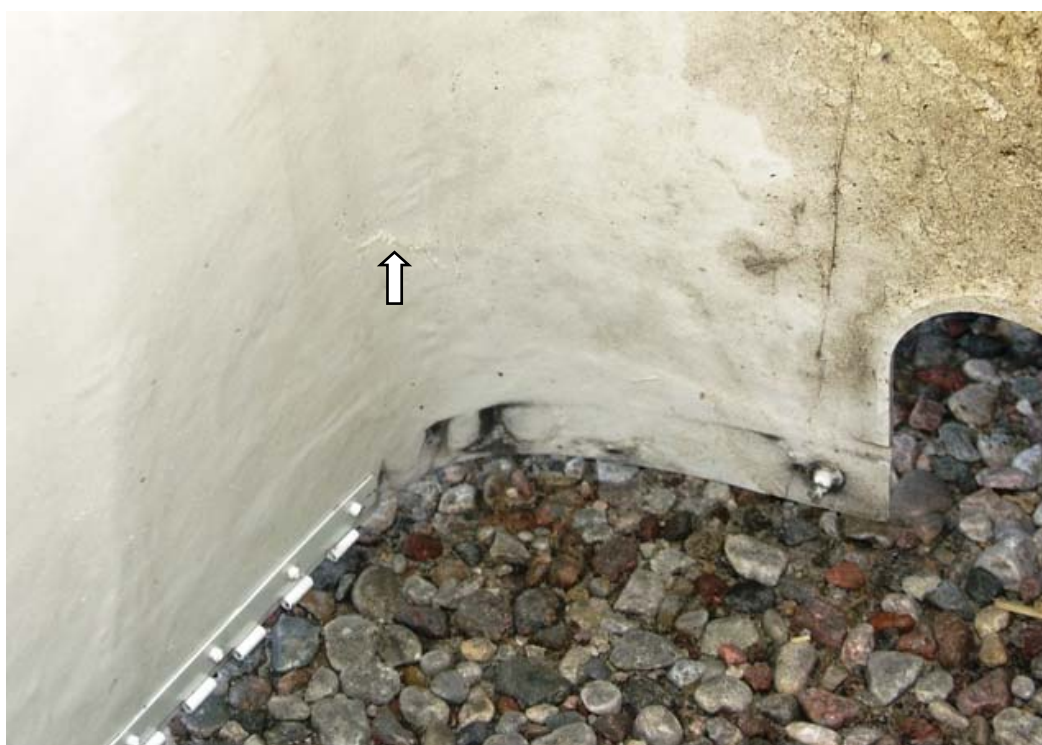
Fot. 14 – Ślad pęknięcia widoczny od środka osłony - lewa strona
