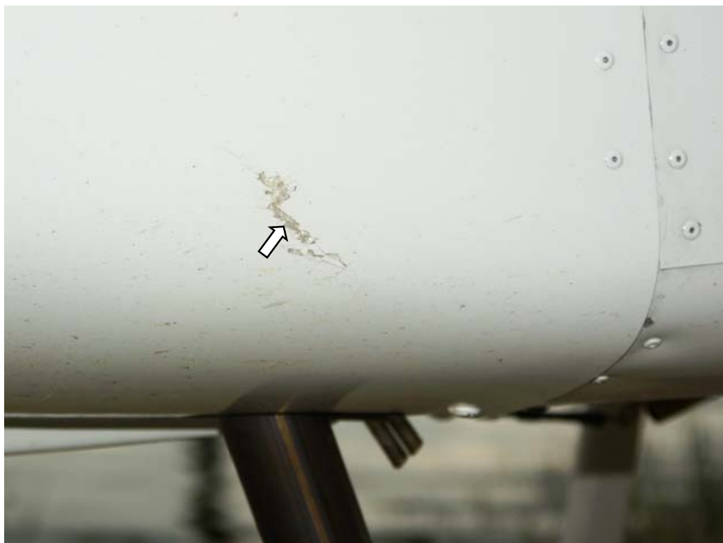
Fot. 13 – Widoczne ślady pęknięcia dolnej osłony silnika - lewa strona
