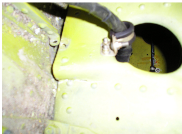
Fot.6 – Uszkodzenie szwów nitowych.
