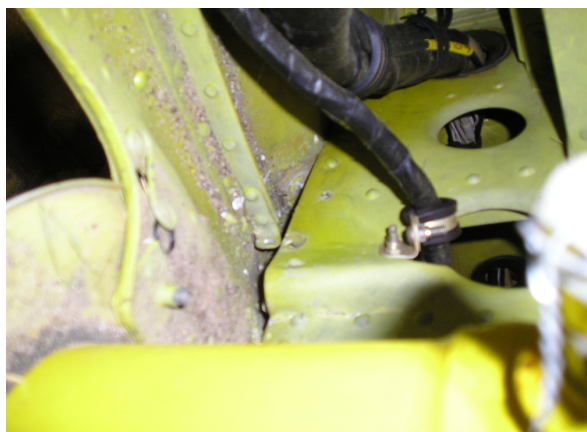
Fot.7 – Uszkodzenie szwów nitowych.
