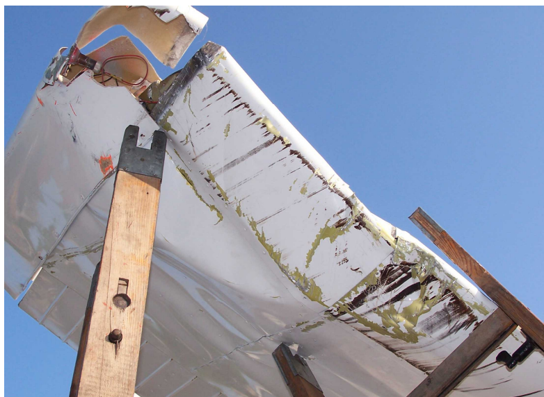
Fot.5 – Końcówka prawego skrzydła zniszczona po zderzeniu z krawędzią dachu budynku.
