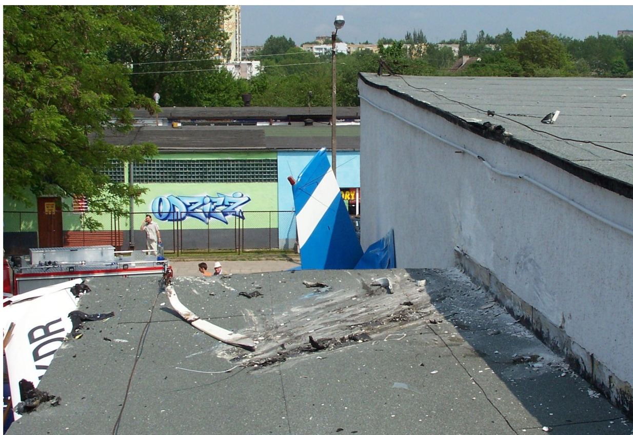
Fot.4 – Ślady uderzenia samolotu na daszku nad wejściem do budynku i na ścianie. Z lewej strony zdjęcia, na krawędzi daszku widać ślady uderzenia goleni lewego podwozia głównego i goleni podwozia przedniego. Na daszku leży odłamana goleń lewego podwozia głównego i odłamki pokrycia kadłuba. Wyraźnie widać ślad kadłuba samolotu.
