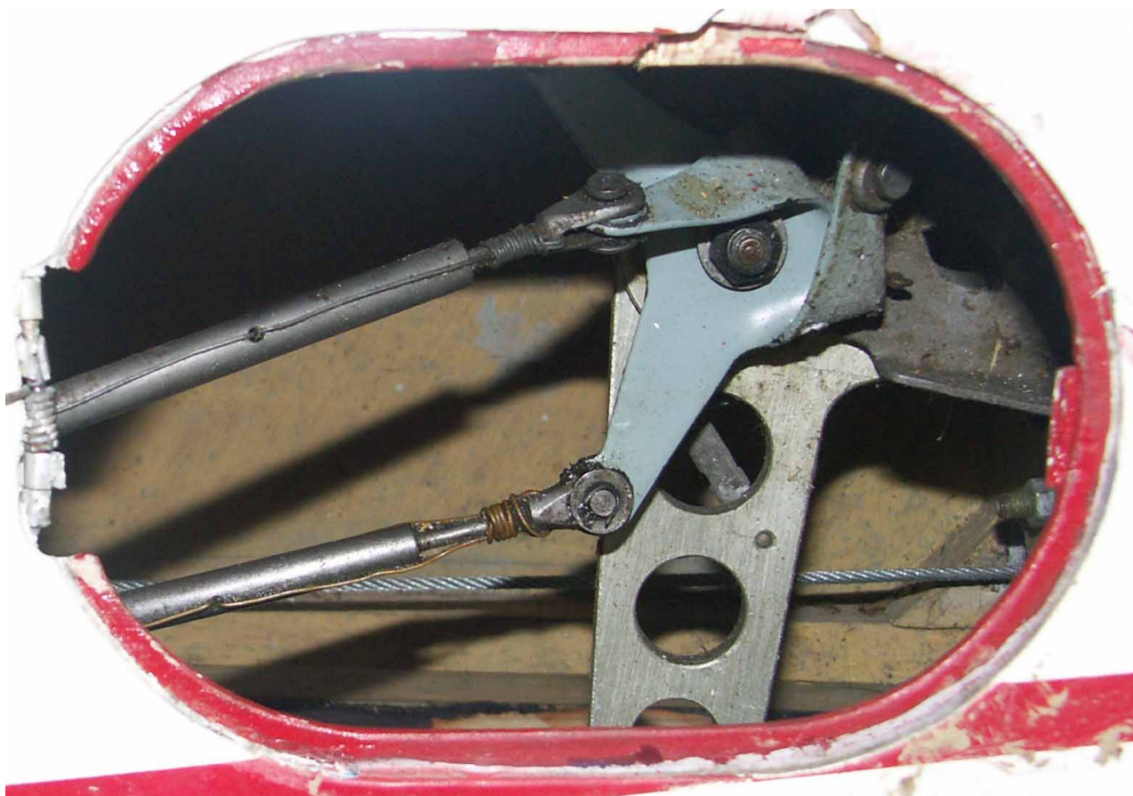
13 – Widok uszkodzonych dźwigni sterowania sterem wysokości we wznierniku w tylnej części kadłuba u nasady usterzenia.
