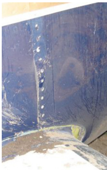
15 – Zerwany szew nitowy wręgi kadłuba na wprowadzeniu przedniego dźwigara prawego skrzydła.
