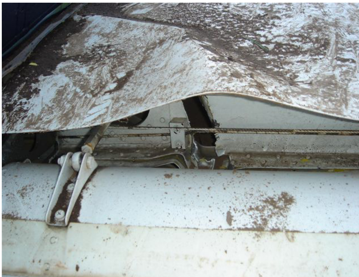
21 – Uszkodzenia dźwigara tylnego i pokrycia prawego skrzydła u nasady – widoczne rozerwanie dźwigara.
