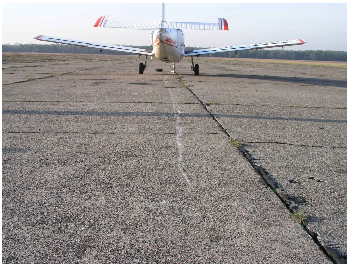
3 – Samolot po zatrzymaniu się na pasie – widoczna rysa na betonie.
