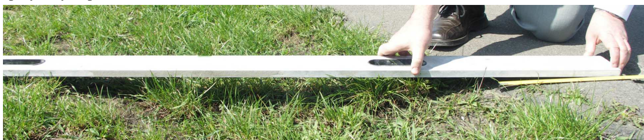
Fig.8 – Fotografia profilu nawierzchni trawiastej przy krawędzi bocznej asfaltowej drogi kołowania w płaszczyźnie kołowania samolotu. Cień liniału dobrze uwydatnia profil zagłębienia.
