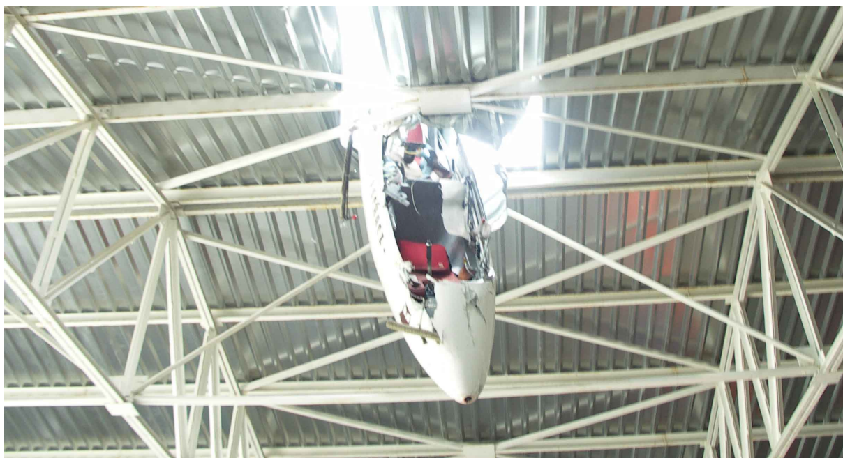
14 – Kabinowa część kadłuba szybowca wewnątrz hangaru po przebiciu dachu, od góry.
