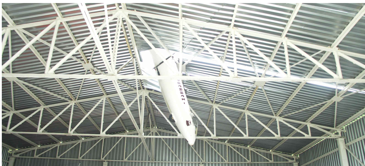
13 – Kabinowa część kadłuba szybowca wewnątrz hangaru po przebiciu dachu, prawa strona.
