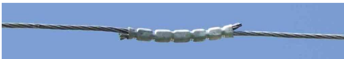
8 – Miejsce uderzenia w linię energetyczną na zbliżeniu, widoczny zerwany przewód po naprawie.
