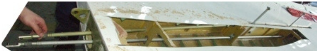
78 – Keson prawego skrzydła otwarty dla stwierdzenia ciągłości układów sterowania [fot.PKBWL].
