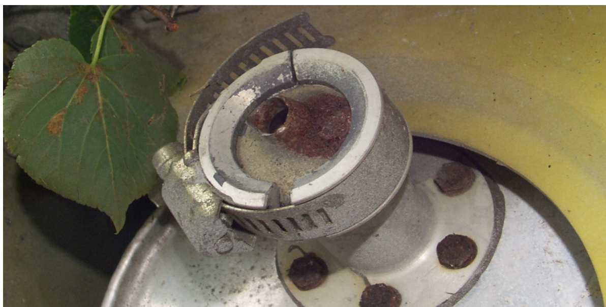
21 – Końcówka przewodu paliwowego na zbiorniku skrzydłowym w zbliżeniu – widać zaawansowaną korozję części.
