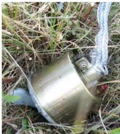
38 – Przełącznik iskrowników wyrwany z tablicy przyrządów SP-ELE.
