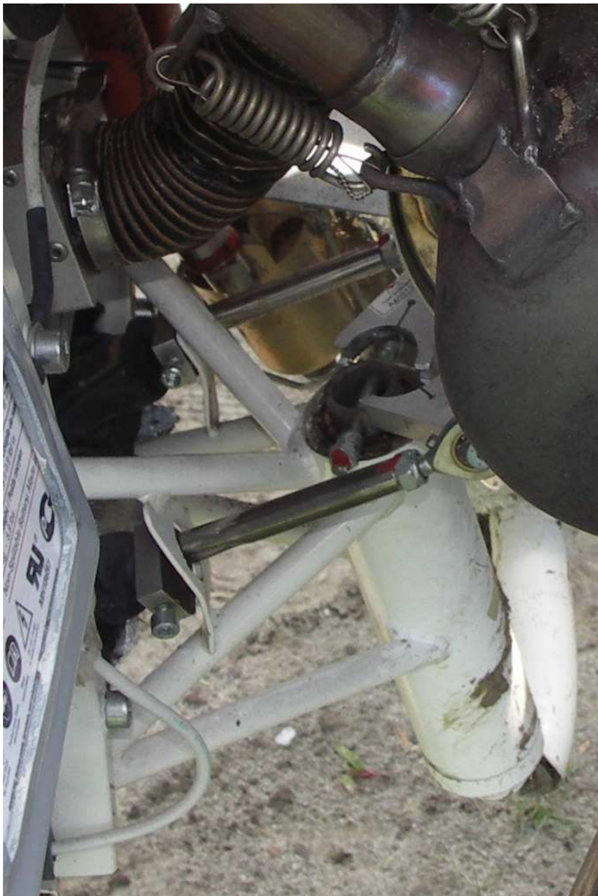
18 – Zniszczone podwozie przednie na samolocie, prawa strona. Widoczne popychacze sterowania podwoziem i zniszczona dźwignia sterowania, do której są zamocowane ich końcówki.
