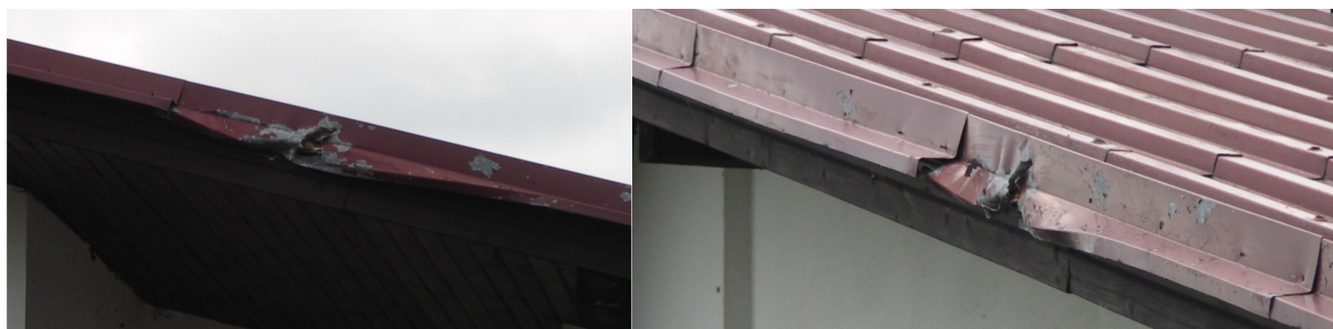
10 i 11 – Uszkodzenie krawędzi dachu, spowodowane przez łopatę wirnika nośnego śmigłowca.
