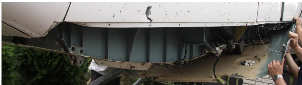
22 – Prawy dźwigar wzdłużny kadłuba z widocznymi uszkodzeniami w części środkowej.
