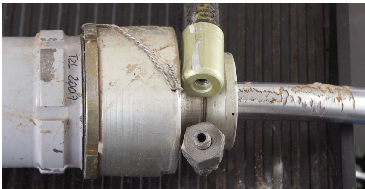
53 – Zbliżenie na fragment siłownika pneumatycznego ze złączem i końcówkę przewodu zasilania. Widoczny doraźny charakter zniszczenia.
