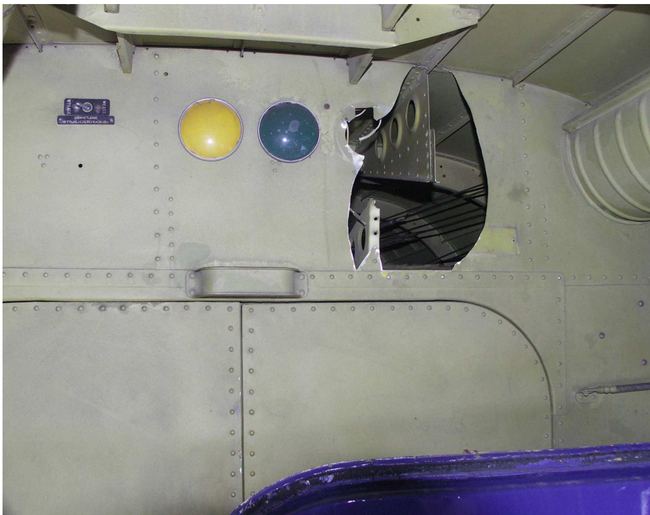
1 – Ogólny widok uszkodzonej wręgi od strony kabiny transportowo-desantowej – widoczne wyrwanie znacznego fragmentu ścianki wręgi wraz z lampką sygnalizacyjną czerwoną.
