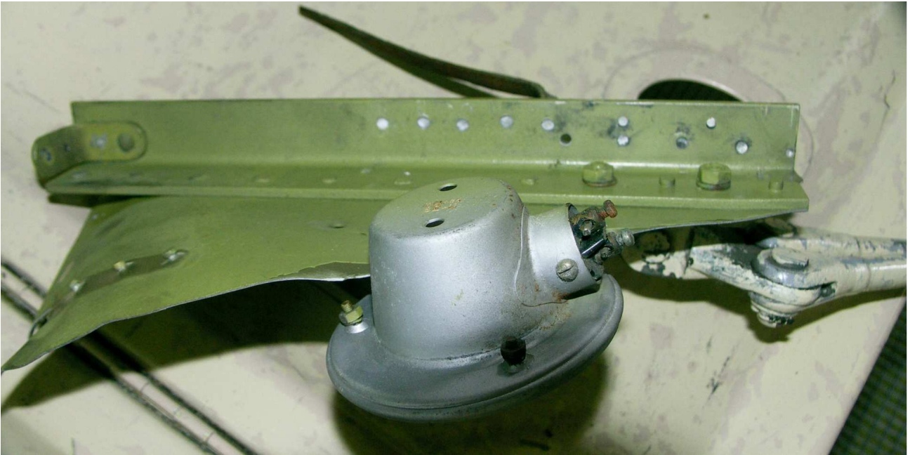
8 – Wyrwany fragment ścianki wręgi wraz z zamocowaniem linek desantowych i wzmocnieniem, widoczna jego lewa strona. Zwracają uwagę rdzenie ściętych nitów, widoczne w otworach we wzmocnieniu – srebrzysty kolor odróżnia je od pozostałych części.
