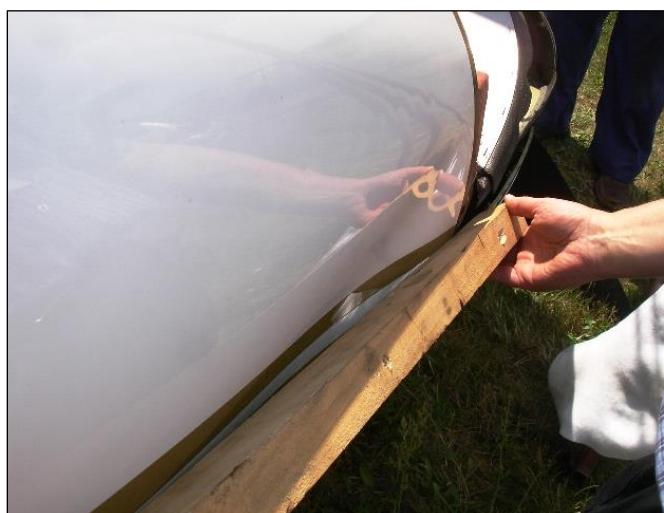
Rys. 8. Uszkodzenia osłon silnika
