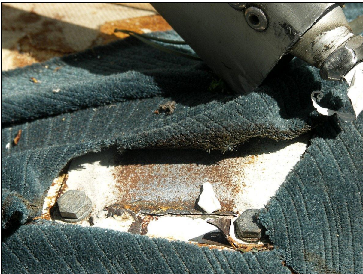
13 – Jedno ze zniszczonych okuć zastrzału górnego skrzydła na kadłubie z wyraźnymi objawami zadawnionej korozji pod wykładziną tapicerki.
