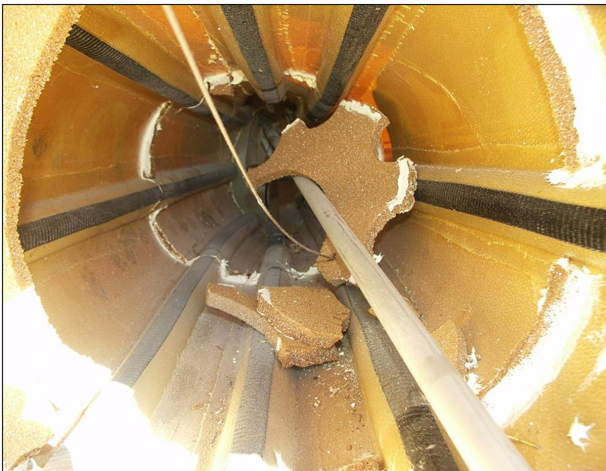
23 – Wnętrze skorupy tylnej części kadłuba. Widoczne fragmenty piankowej wręgi, zniszczonej podczas wypadku.
