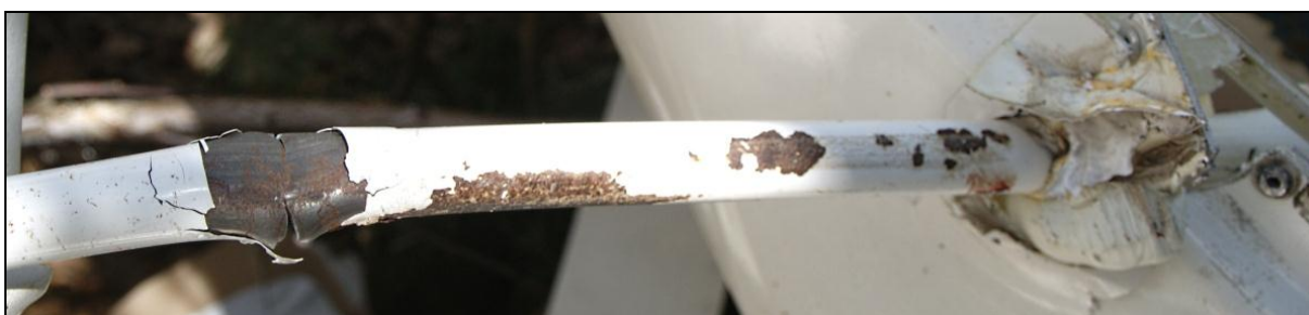
12 – Jedna ze stalowych rurek struktury nośnej z wyraźnymi objawami zaawansowanej korozji.
