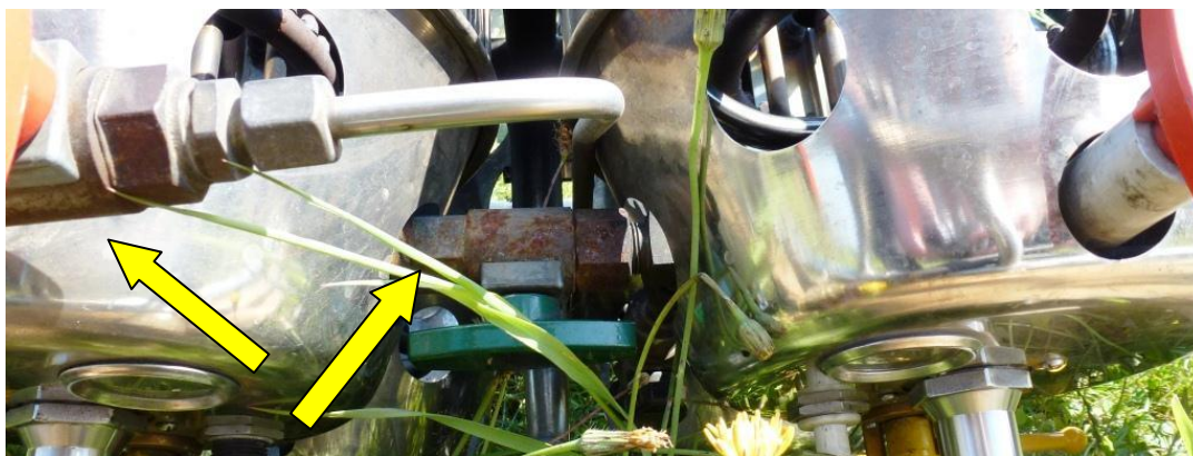
Fot. 3. Strzałki wskazują ślady korozji na krzyżowych zaworach kulowych palnika. Fot. PKBWL.
