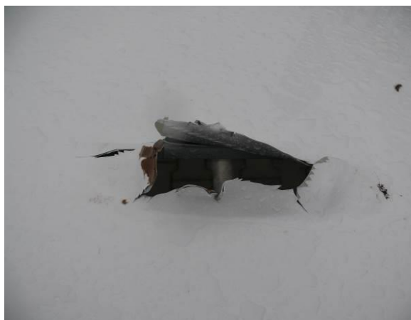
Rys. 18 Zbliżenie na otwór w górnym pokryciu skrzydła.
