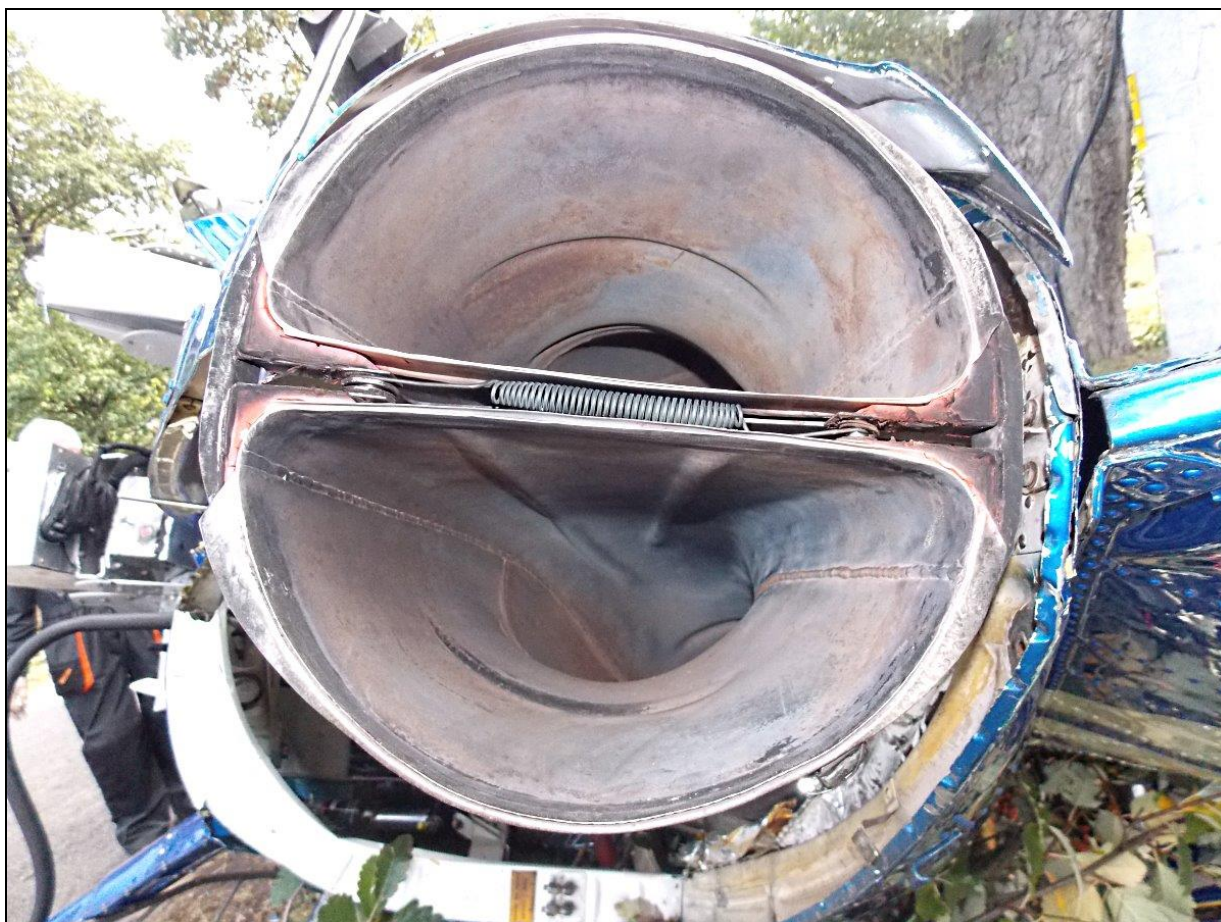
21 – Wyloty spalin z silnika.
