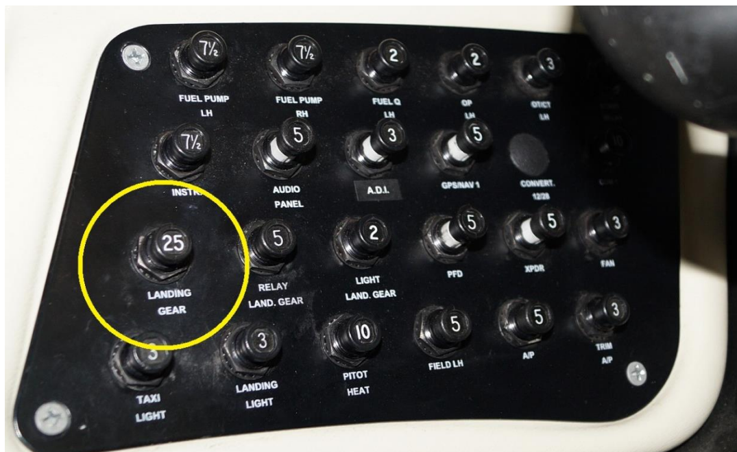
Rys. 10. Panel bezpieczników samolotu Tecnam P2006T zawierający bezpiecznik „LANDING GEAR” zabezpieczający obwód silnika pompy hydraulicznej układu chowania i wypuszczania podwozia [źródło: PKBWL]
