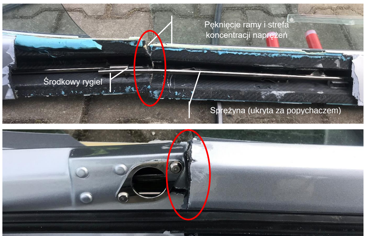
Rys. 8 Pęknięta „na wskroś” rama osłony kabiny w pobliżu miejsca osadzenia środkowego rygla. Karb występuje na krawędzi wzmocnienia otworu pod okucie/zamek na ramie. [źródło: PKBWL]
