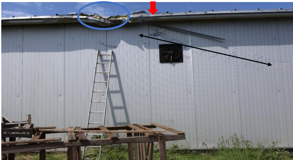
Rysunek 3. Miejsce uderzenia samolotu w budynek: główne uderzenie w krawędź dachu (niebieskie kółko), uderzenie prawego skrzydła (linia czarna), uderzenie przedniej części kadłuba (strzałka czerwona).
