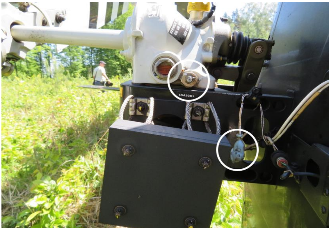
Rysunek 5. Uszkodzony wziernik kontroli oleju, zerwany przewód kontroli chip dedektor w przekładni kątowej.
