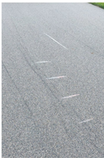
Rys. 1 Ślady uderzenia końcówek śmigła o nawierzchnię drogi startowej (źródło: użytkownik)
