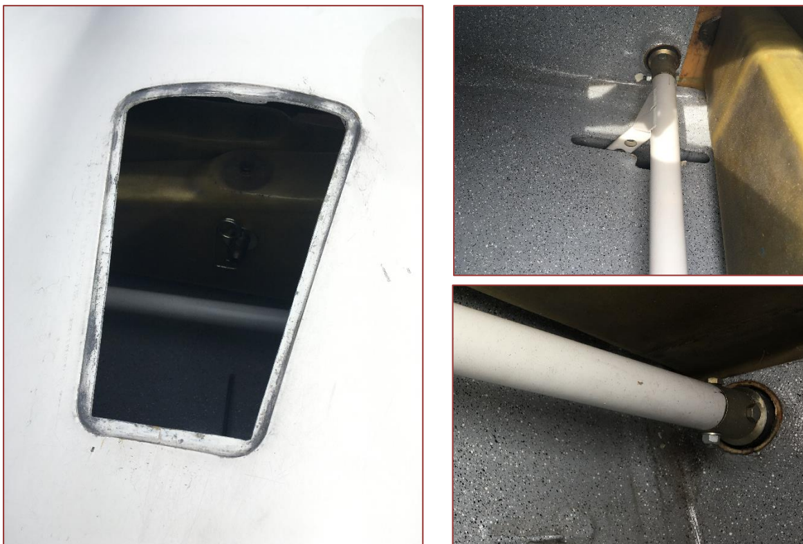
Rys. 15. Napęd hamulców aerodynamicznych – bez widocznych uszkodzeń
