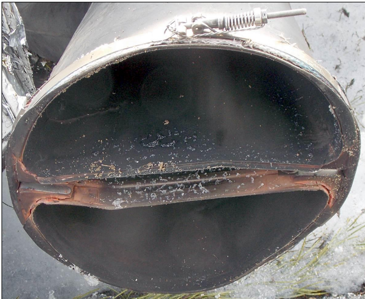
19 – Rury wylotowe spalin silnika. Widoczny znaczny osad sadzy.
