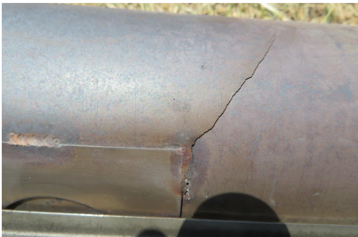
Rys.7 Pęknięcie na cylindrycznej ścianie tłumika.[Źródło, PKBWL]
