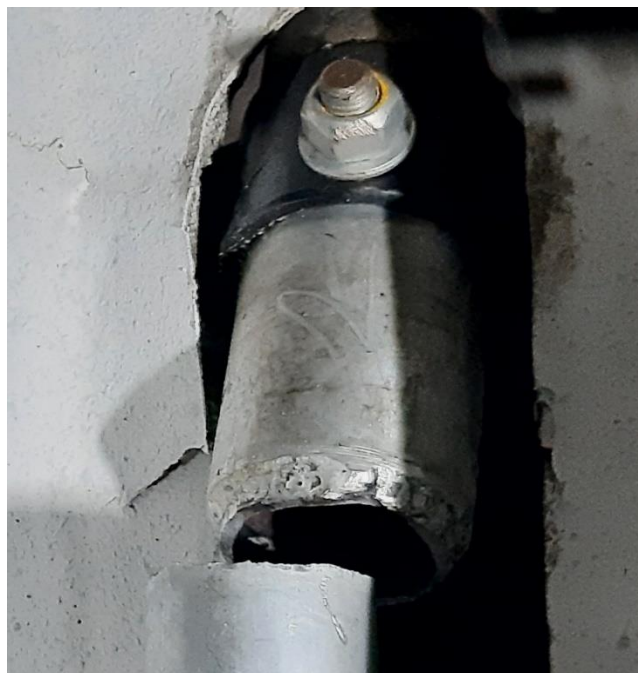
Rys. 4. Na zdjęciu pokazano miejsce pęknięcia goleni. Widoczne jest połączenie spawane [źródło: PKBWL]
