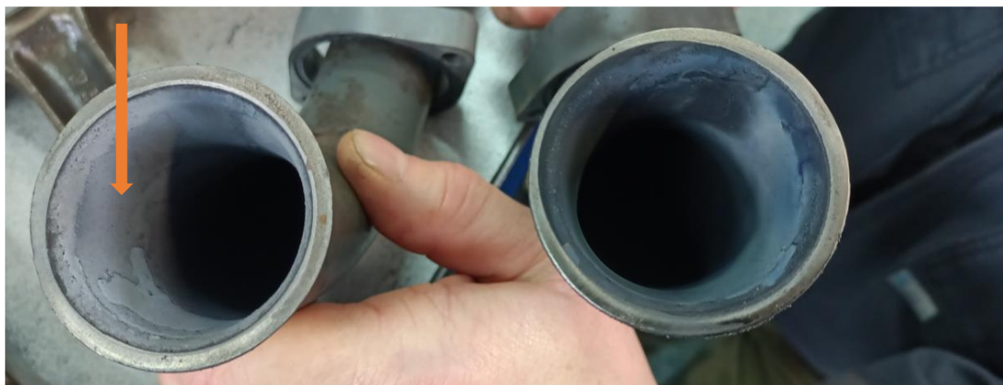
Rys.3 Widoczny nagar w rurze ssącej
