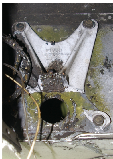
25, 26 – Zniszczone okucie tylne na samolocie.
