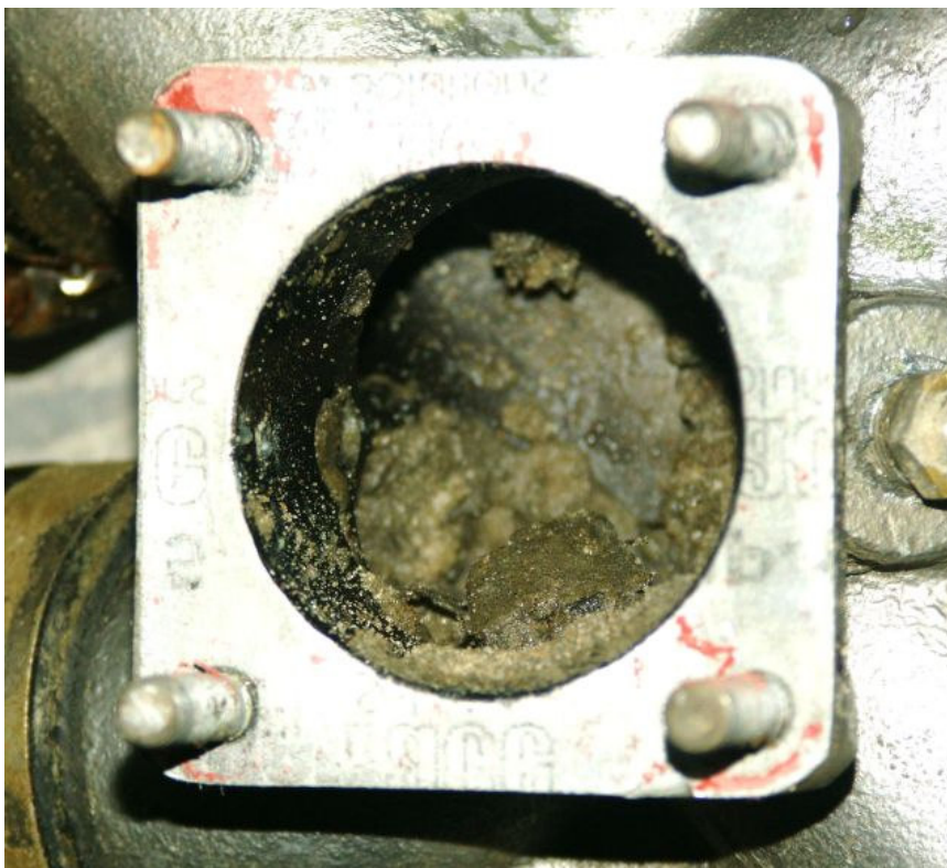
85. Szlam w silnikowym kanale wlotu mieszanki.
