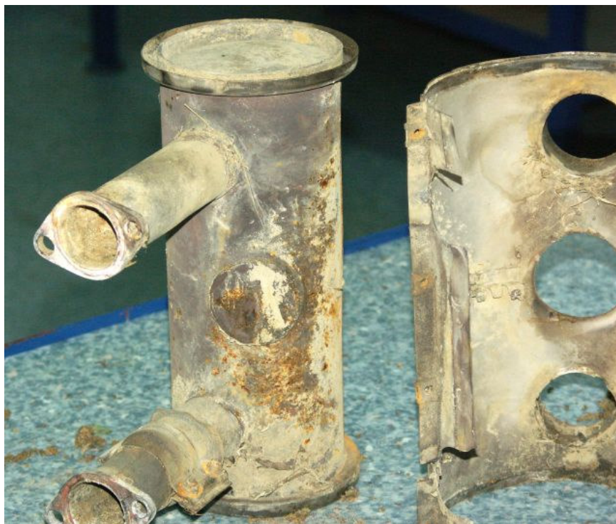
91. Kolektor ze zdemontowanym płaszczem nagrzewnicy. Widoczna na zdjęciu łatka jest szczelna.
